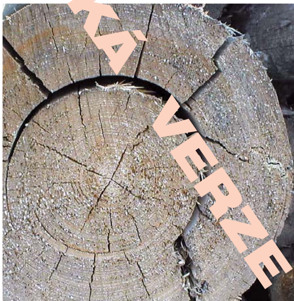
Odlupčivá trhlina Přecházející trhlina
